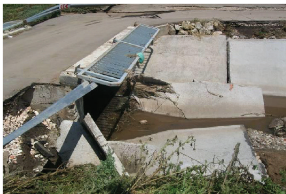
Сн. 7. Разрушена е пътната инфраструктура
